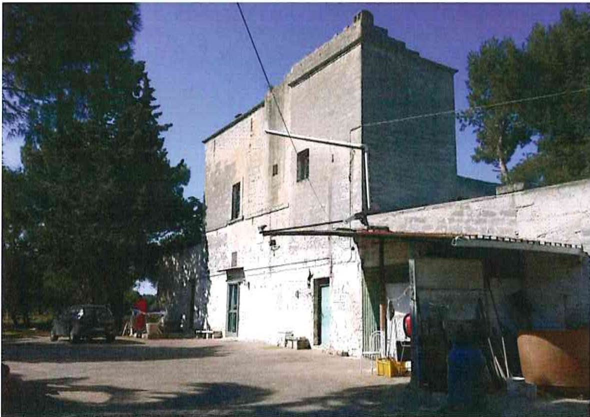
Fig. 9: Vista del casale di S. Maria (SA 68) nel suo attuale stato di conservazione (ottobre 2010).
